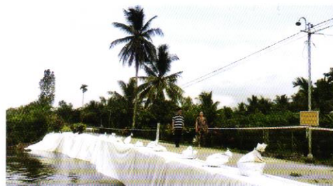
Đoạn sạt lở tại ấp Thanh Phong, xã Tân Long Hội
